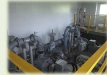
ポンプ設備 (滝本加圧ポンプ室)
