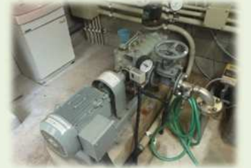
ポンプ設備 (杉ヶ川加圧ポンプ室)
