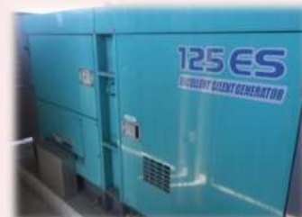
自家発電設備 (滝本加圧ポンプ室)
