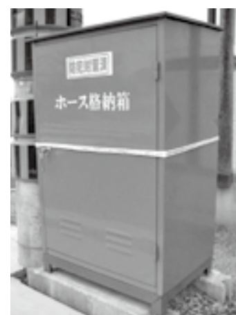
◀ 防犯対策済みの消火栓ボックス
