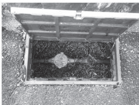
水道メーターボックス
