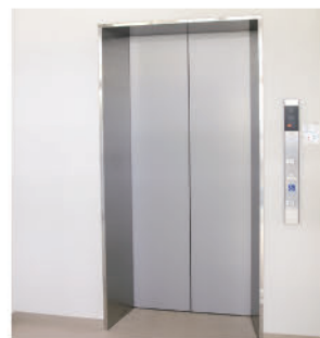
エレベーター
