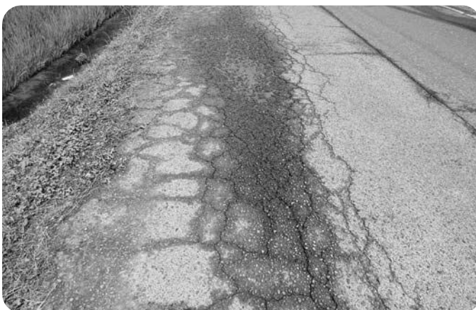
ひび割れた道路
